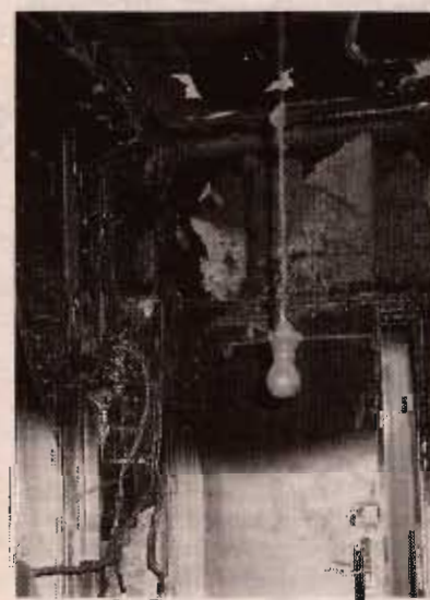
Die ausgebrannte Wohnung.
