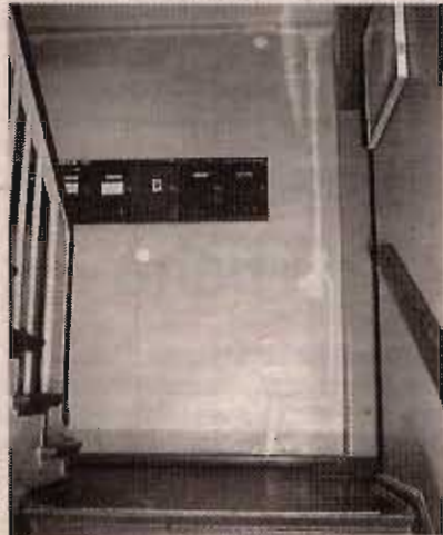
Renovierungsbedürftiges Treppenhaus in Hohenschönhausen.
